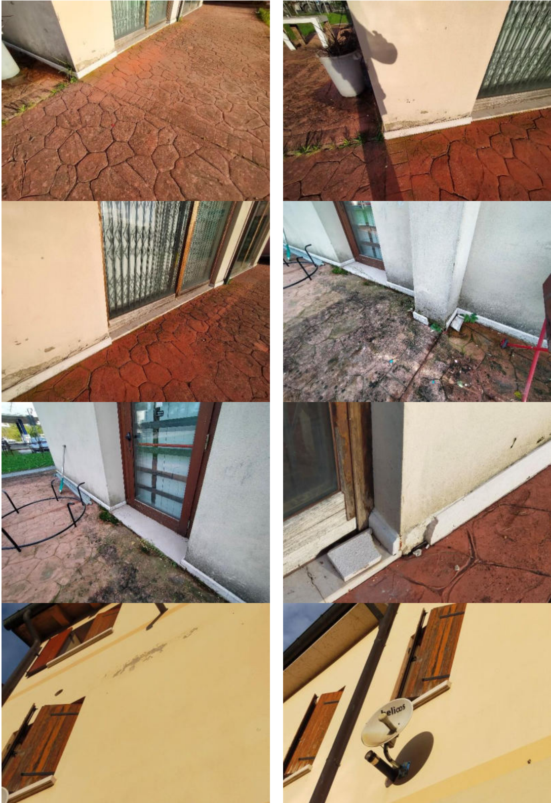
25. Criticità: degrado generale intonaci serramenti e finiture esterne
