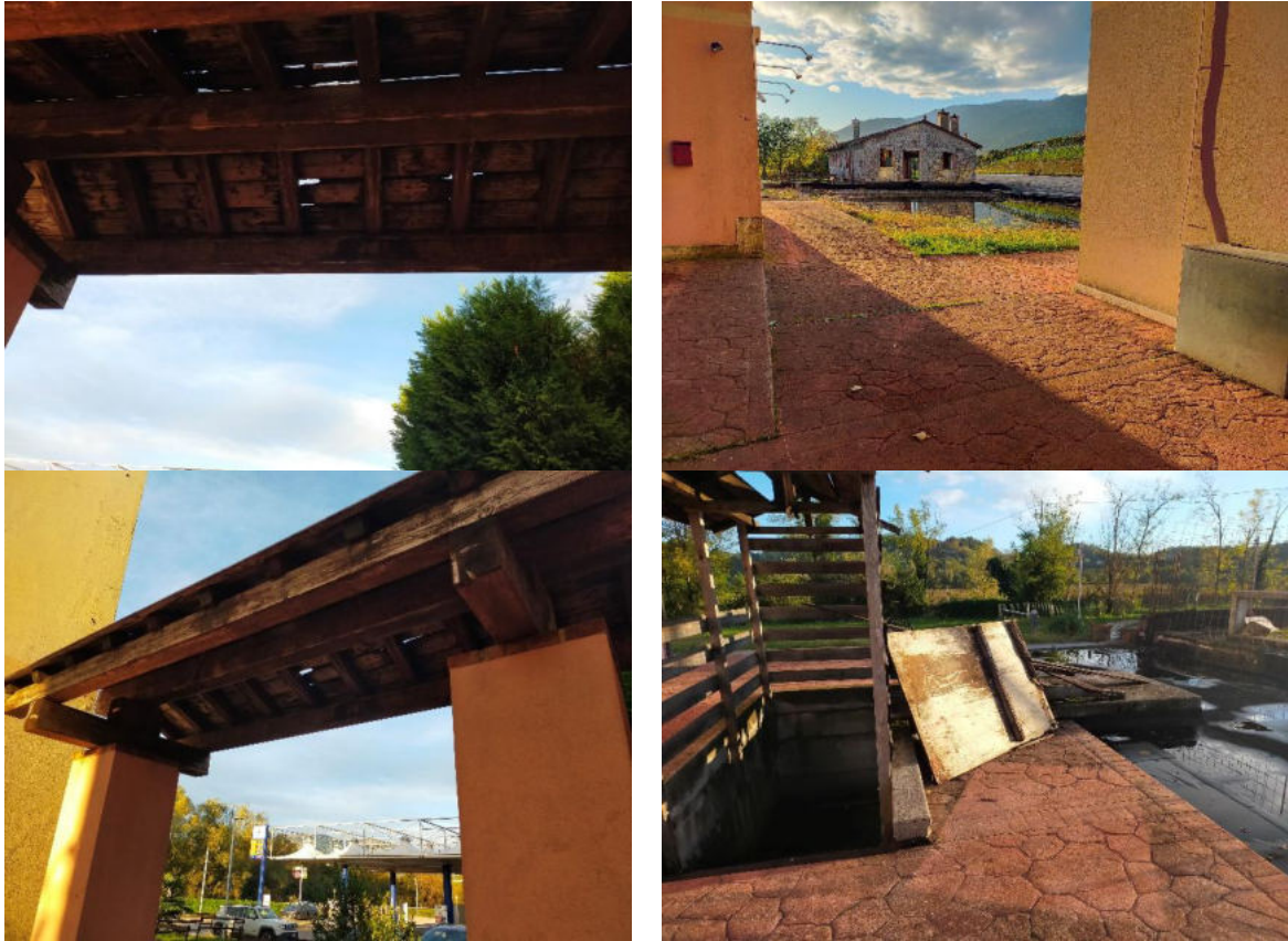
24. Criticità di degrado generale del complesso in cui sono inseriti gli immobili oggetto di stima
