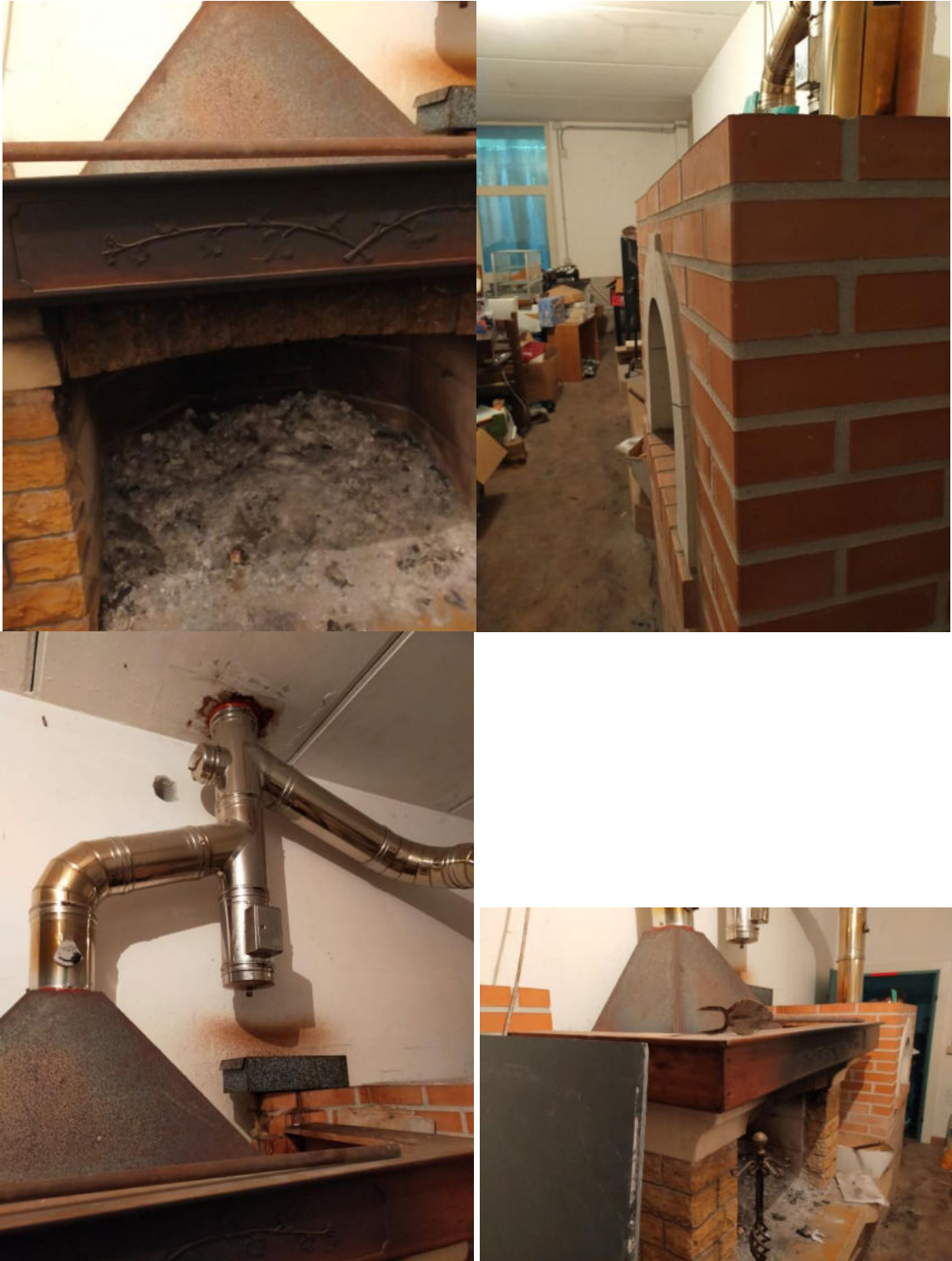
37. Caminetto e forno a legna installati nella cantina
