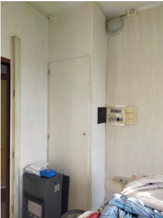
30. Particolari: quadri elettrici, split interno riscaldamento/condizionamento
