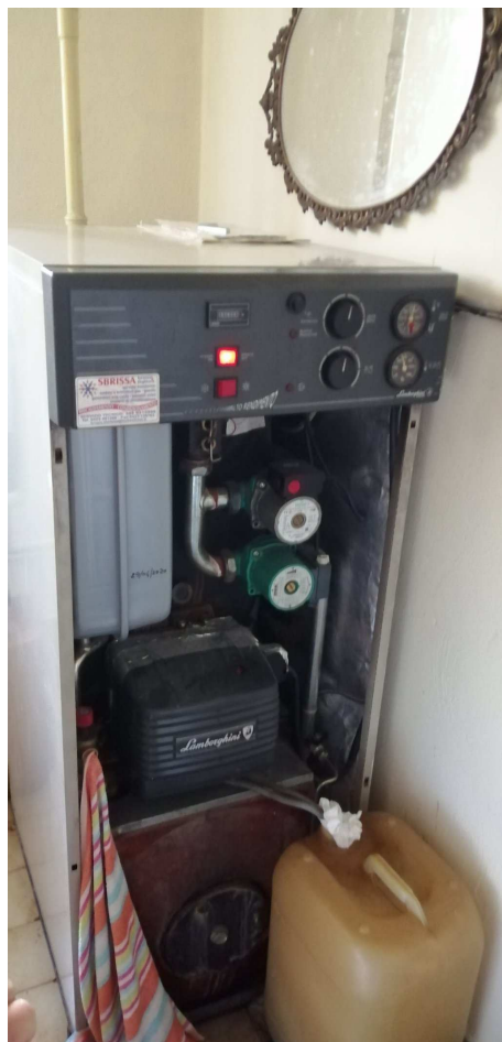
Caldaia a gasolio
