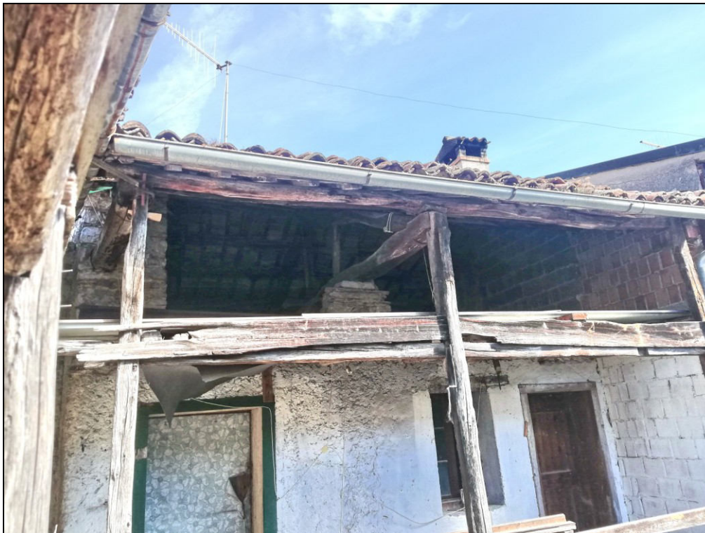
Foto 14 – Soffitta con terrazza non accessibili piano secondo
