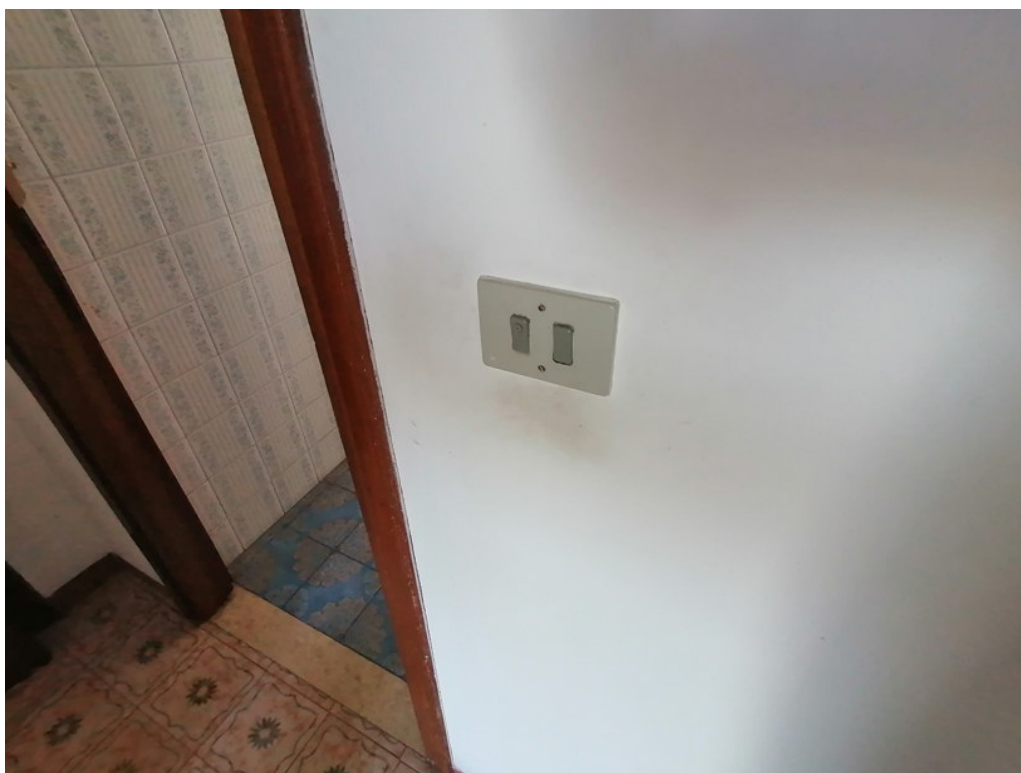
Particolare impianto elettrico e pavimentazione
