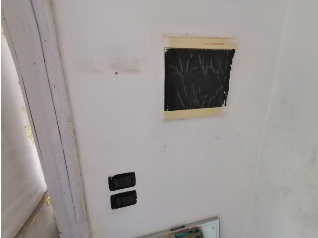
Vista impianto elettrico "alloggio due"
