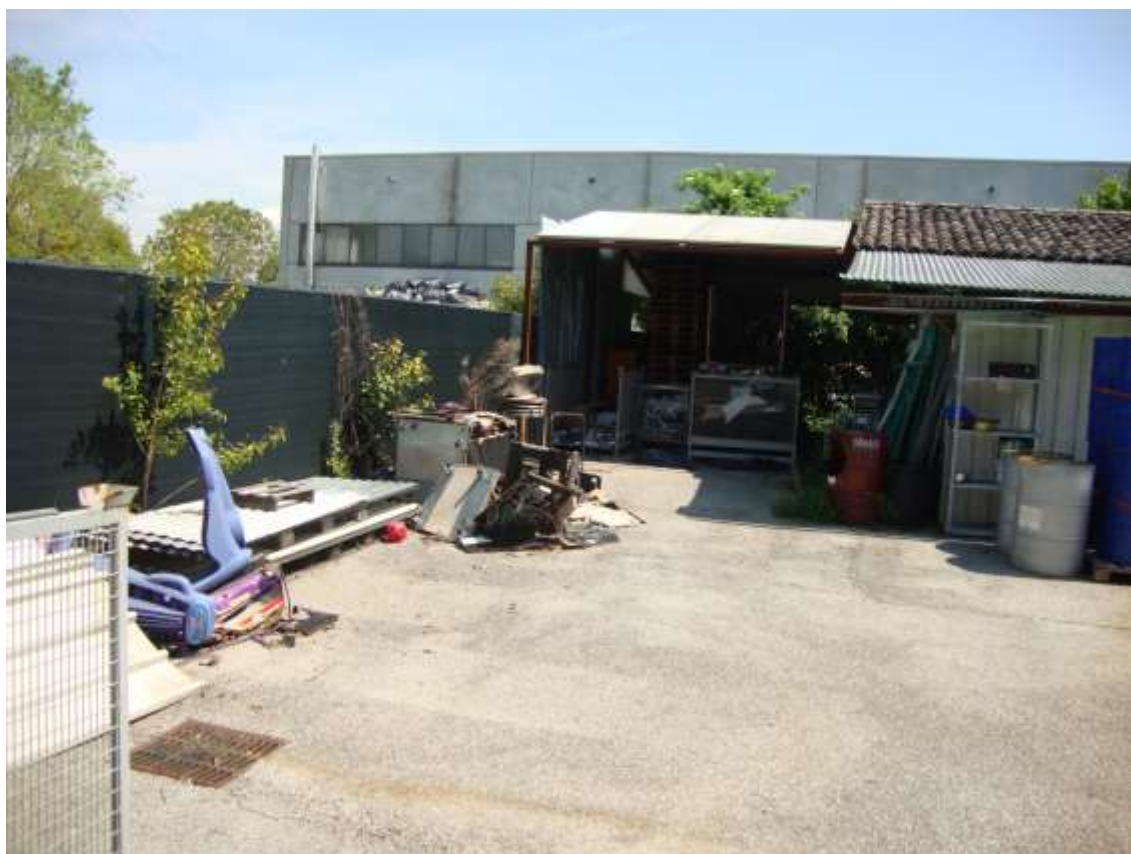
Fig. 4.23 – tettoia abusivamente realizzata a nord del fabbricato (DA DEMOLIRE)
