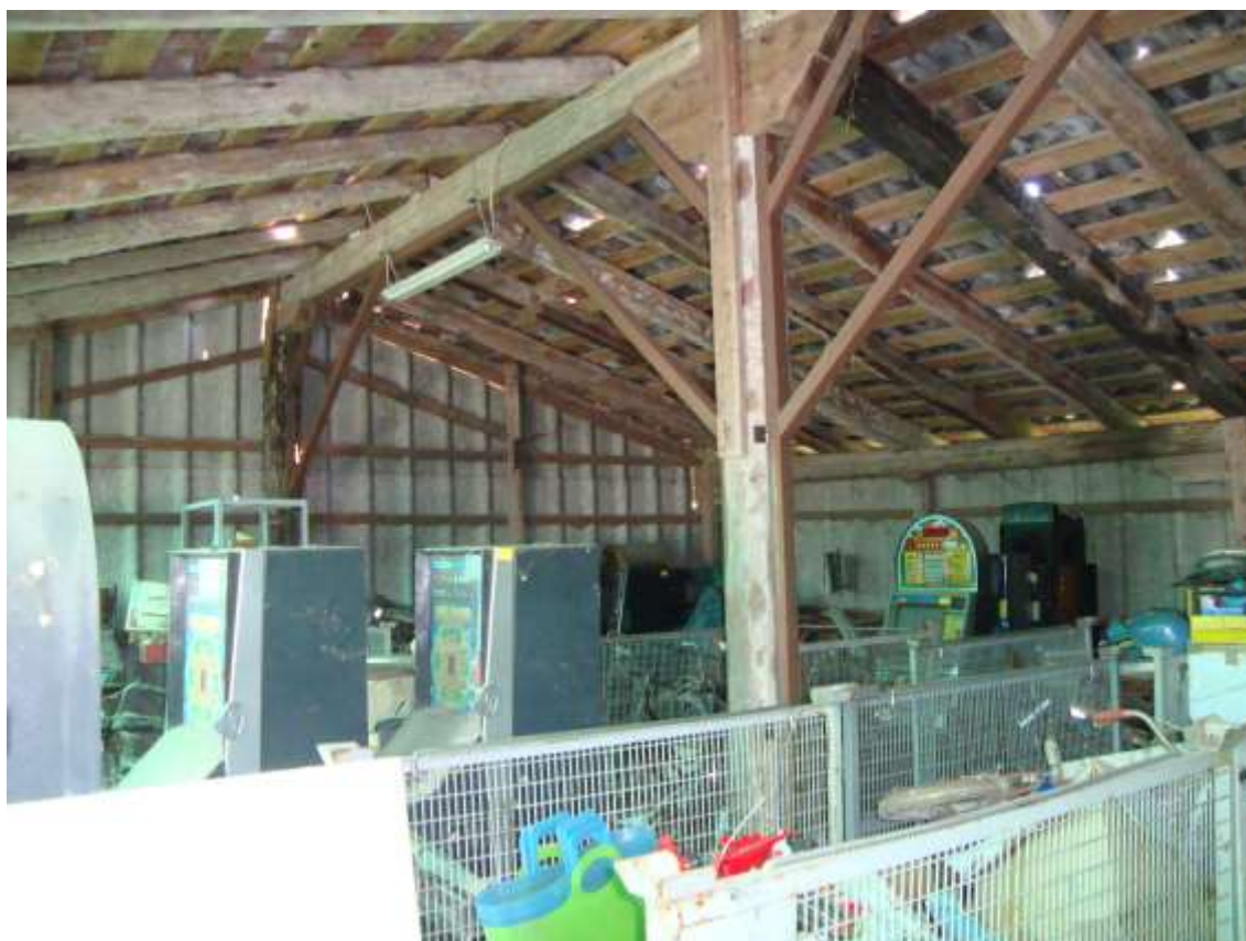
Fig. 4.25 – tettoia abusivamente realizzata a nord del fabbricato (DA DEMOLIRE)
