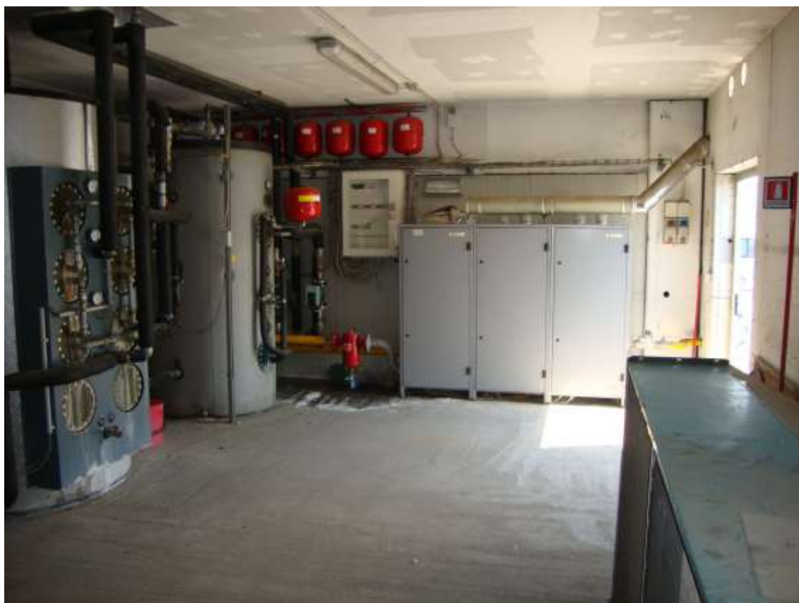
Fig. 1.29 – sala impianti tecnologici piano primo
