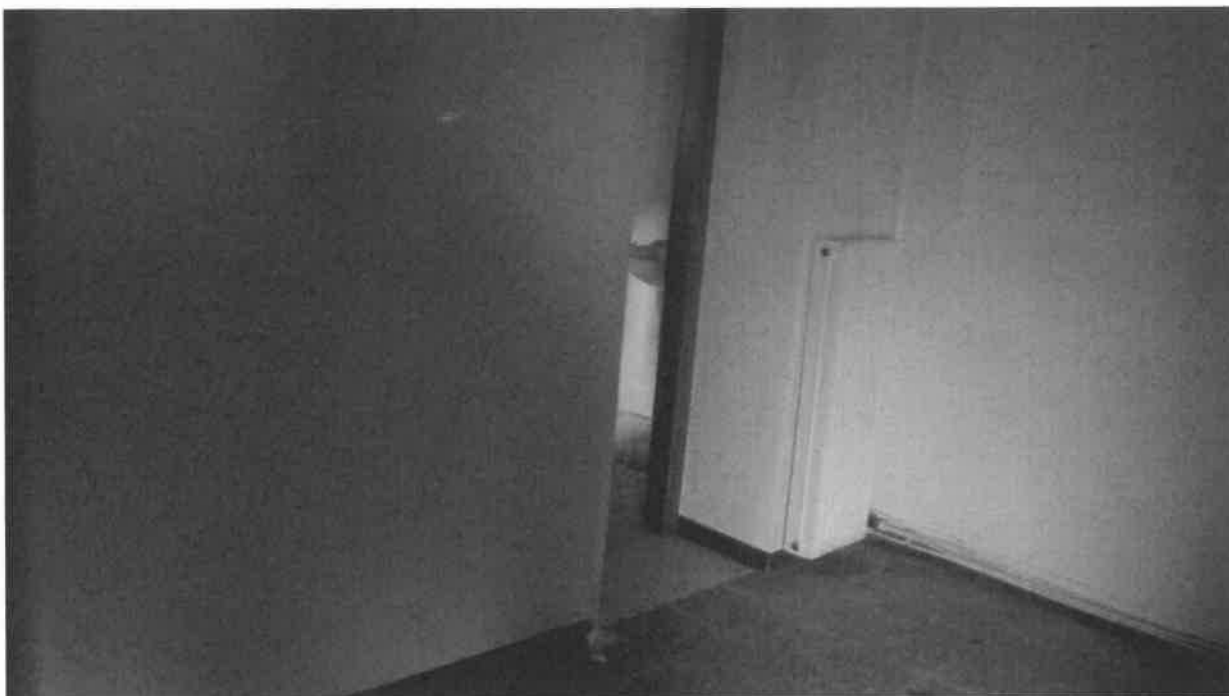
Fotografia 11: la camera a sud-ovest del piano terra con l'accesso al bagno abusivo
