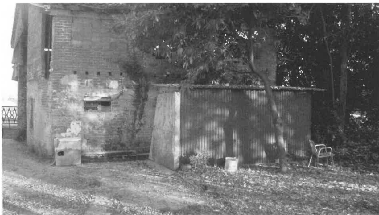
Fotografia 34: il fronte ovest del sub. 4 con la baracca abusiva
