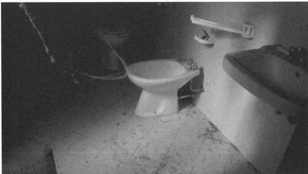
Fotografia 12: il bagno abusivo al piano terra
