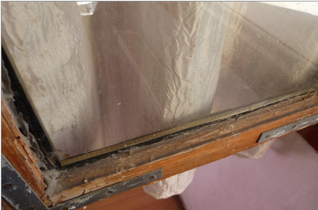
12 Particolare dello stato degli infissi.
