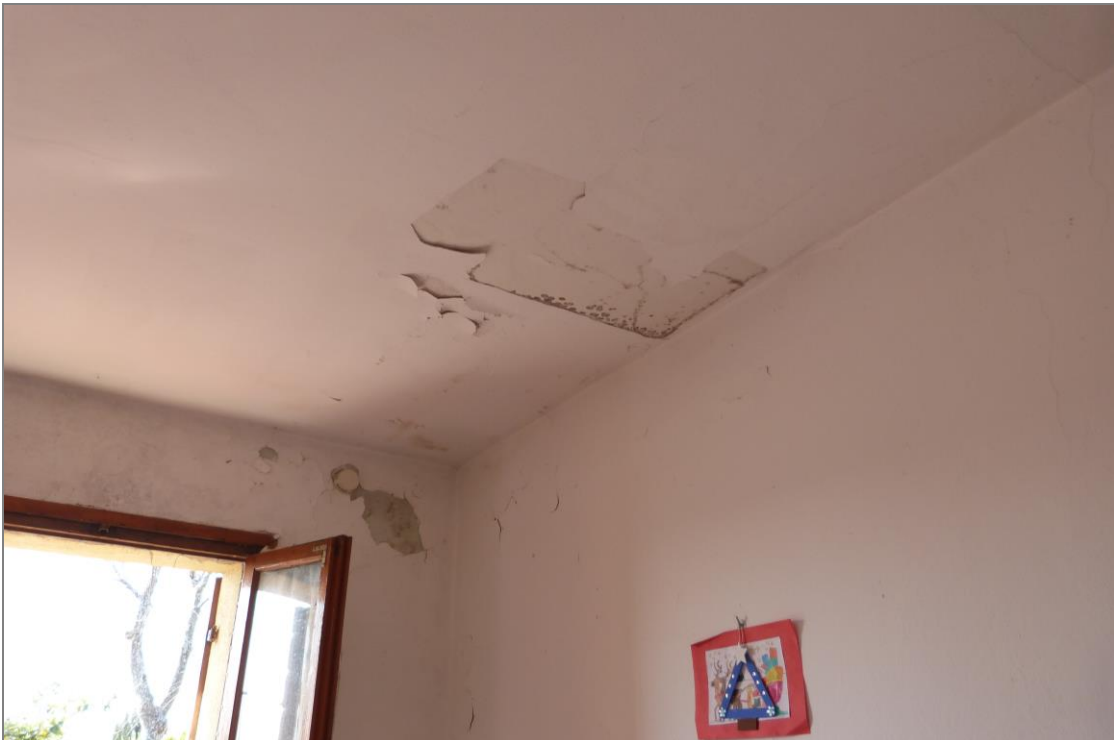
10 Particolare del soffitto e delle pareti della camera con la presenza di pittura scrostata.
