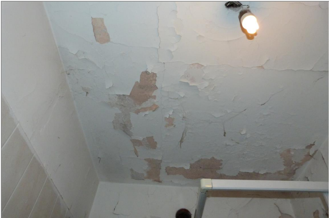
11 Particolare del soffitto del bagno con la presenza di pittura scrostata.
