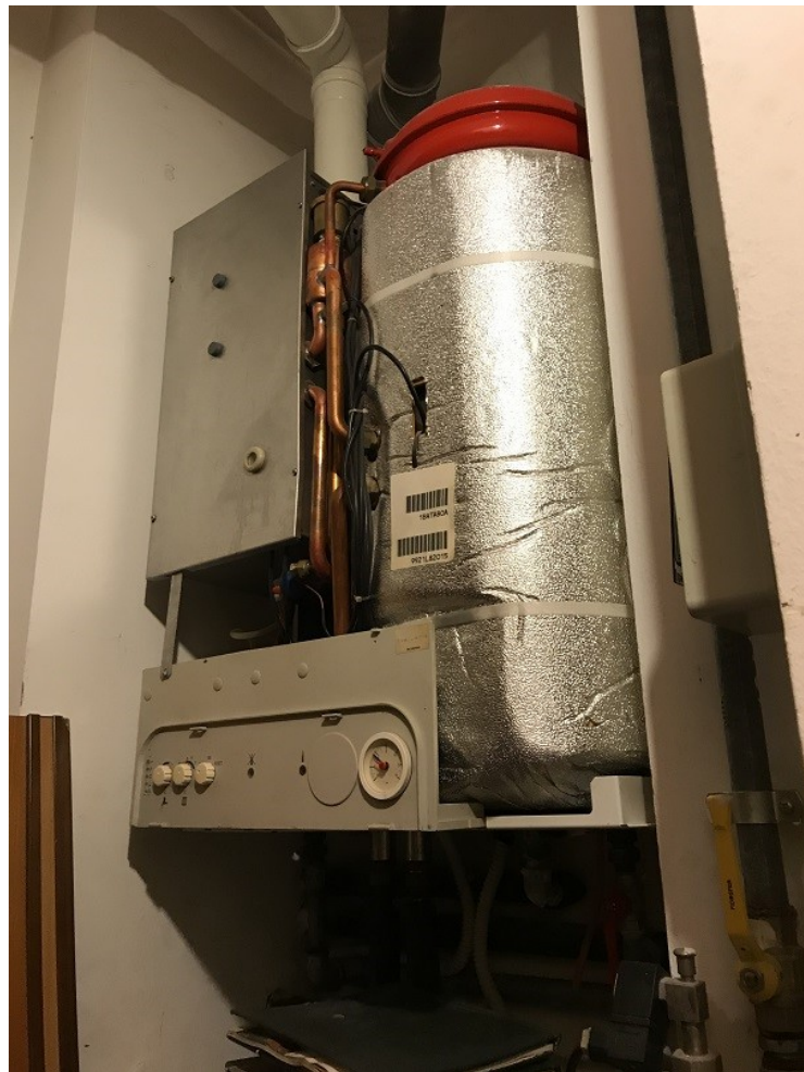
FOTO 19 – caldaia in ripostiglio
