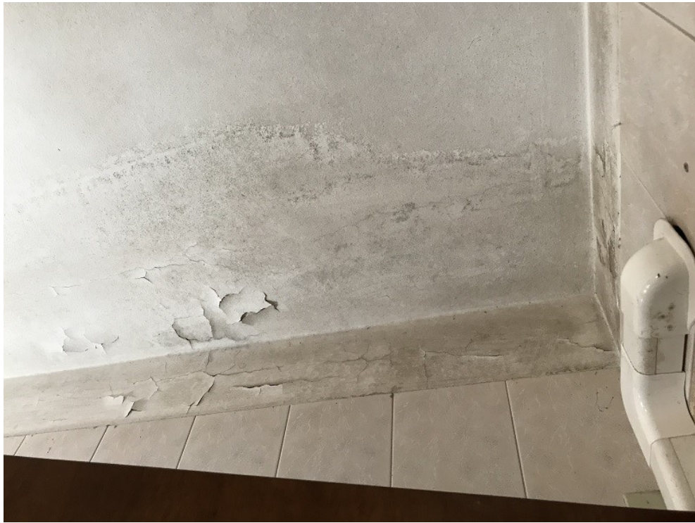
FOTO 16 – segni d'infiltrazione precedente
