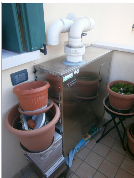
Foto 13 – caldaia a basemento in terrazza
