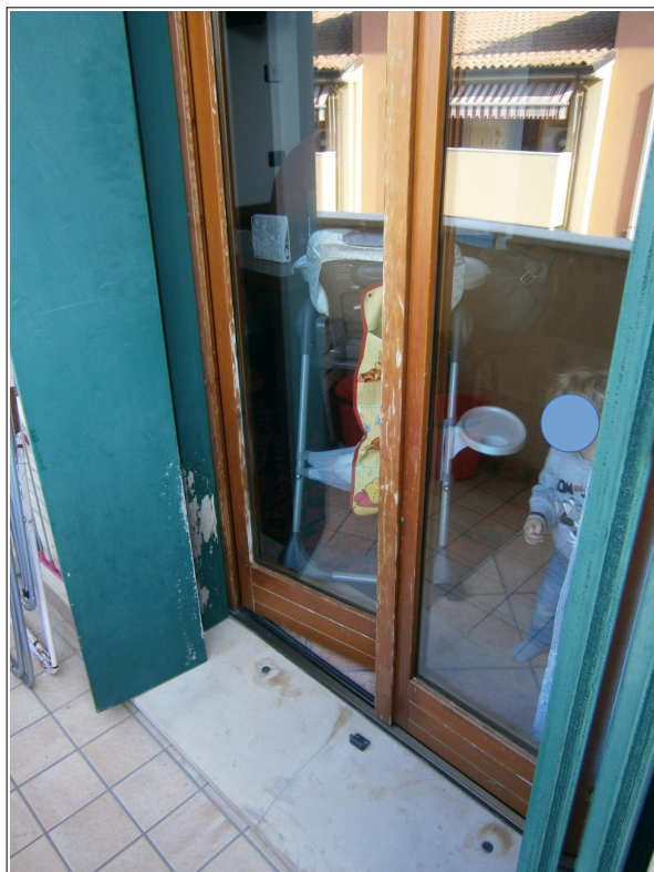
Foto 20 – stato dei serramenti
